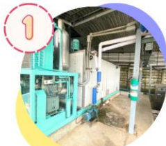
1 ระบบทำน้ำเย็น (Ice Bank) Step 2 แผนกวิศวกรรมโรงงาน
